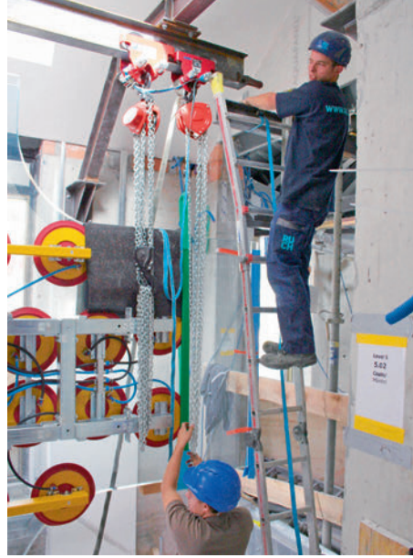
Eine Kranschiene mit Laufkatzen ermöglicht den horizontalen Transport.
